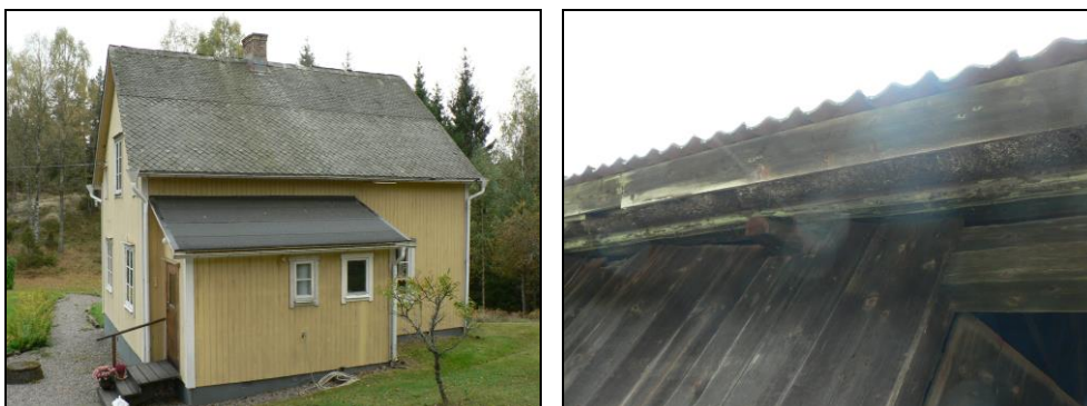
Huset till vänster har skiffertak av två olika typer. Även nocktäckningen är av skiffer. Till höger syns kanten på ett ladutak, där det äldre halmtaket är bevarat under teglet.
