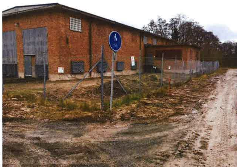
Figur 6. Omformarstationen, vy mot öster
