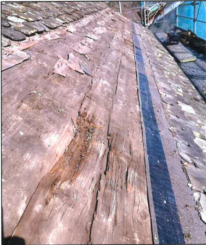
Rötskada på baksidans takfall. Längre bak i bild syns näver som låg över takbrädornas springor. Foto Oliver Lagerlöf.
