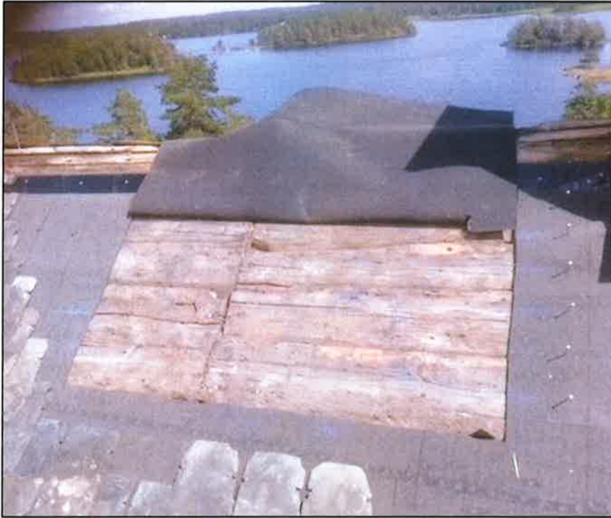
Ytan (ca 1,5 kvm) för rekonstruktion av näverläggningen på taket. Vid nocken t v om södra skorstenen på framsidan. Foto Oliver Lagerlöf.
