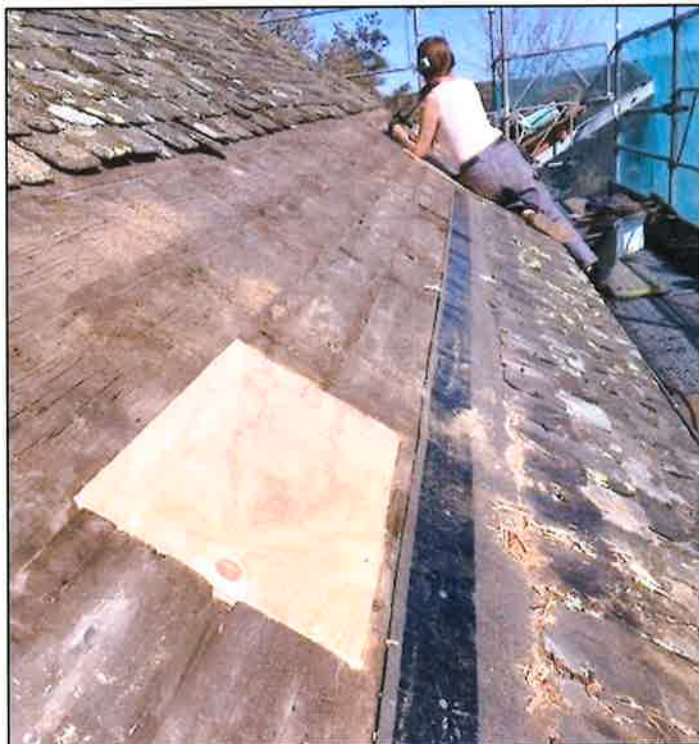
Rötskadan ilagad med plywood. Foto Oliver Lagerlöf.
