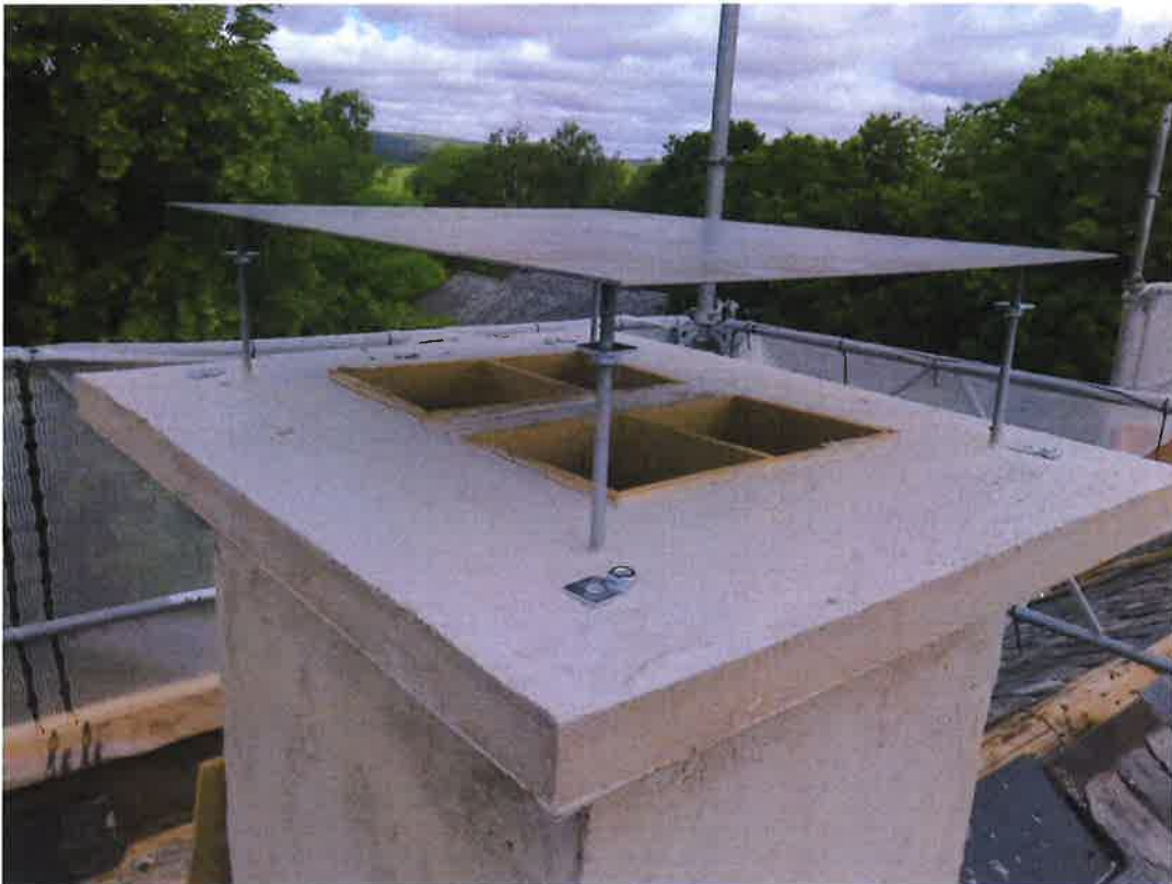
Södra skorstenen under arbete, putsad och med ny krans. Foto Lars Bergström 2022-06-22
