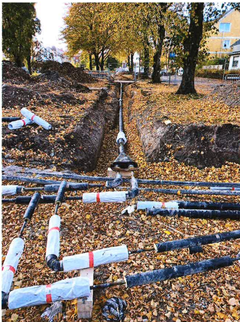
Utbyggnad kulvernät Mellerud
