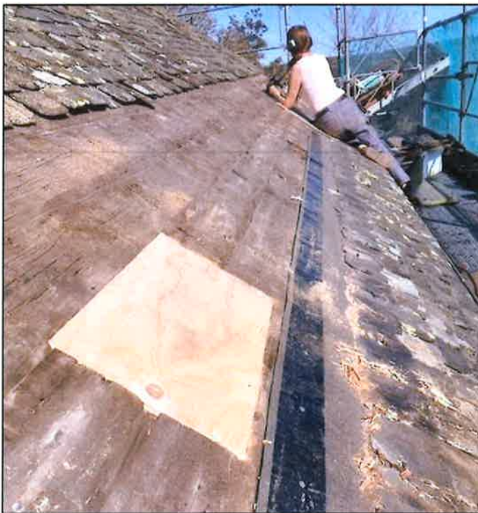
Rötskadan ilagad med plywood. Foto Oliver Lagerlöf.
