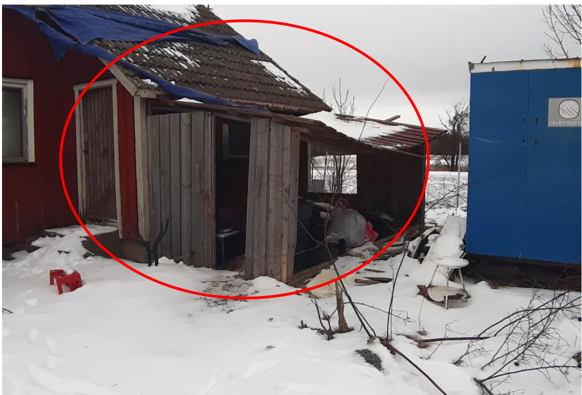
Bild över skärmtaket som ska åtgärdas.
