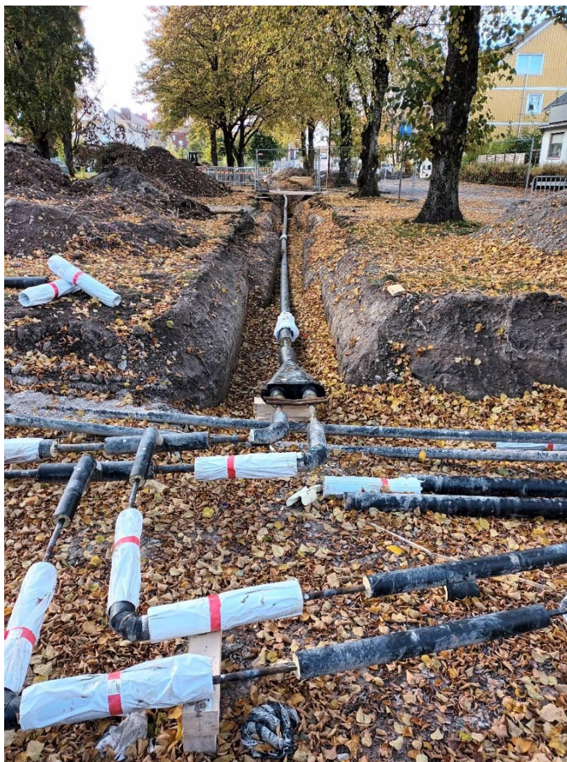
Utbyggnad kulvernät Mellerud
