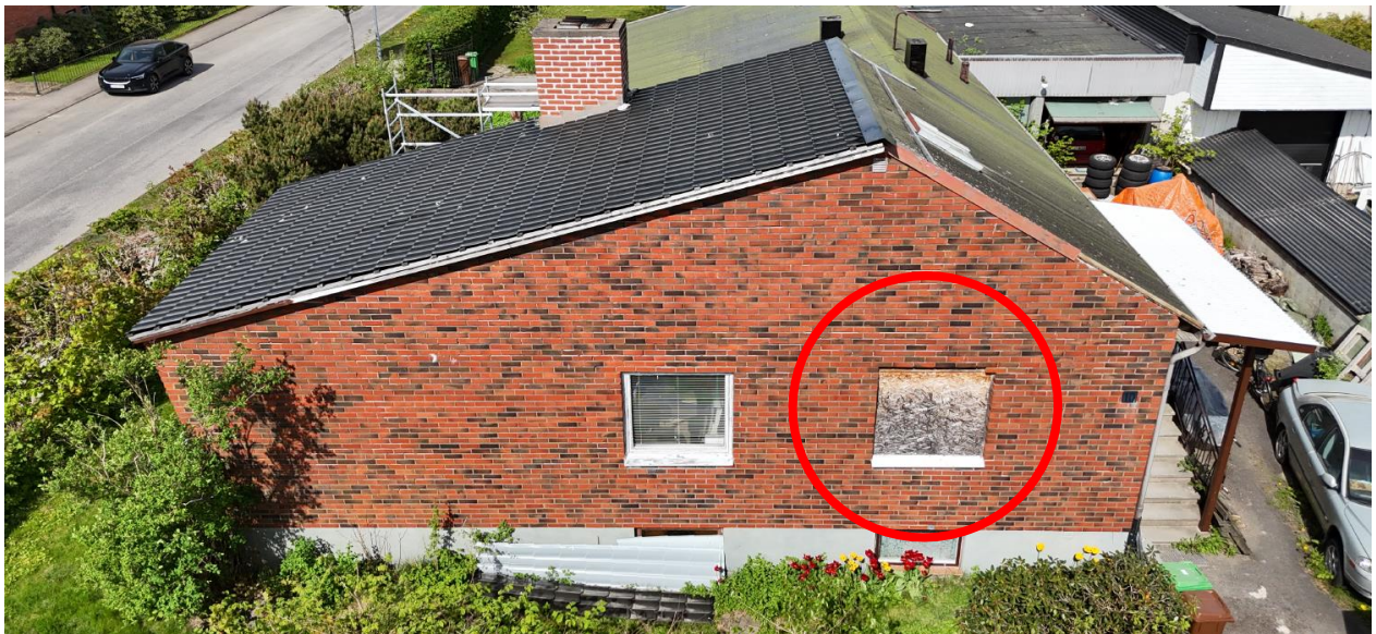
Foto D. Fönster på den östra fasaden som är igensatt av skivmaterial, se röd ring.
