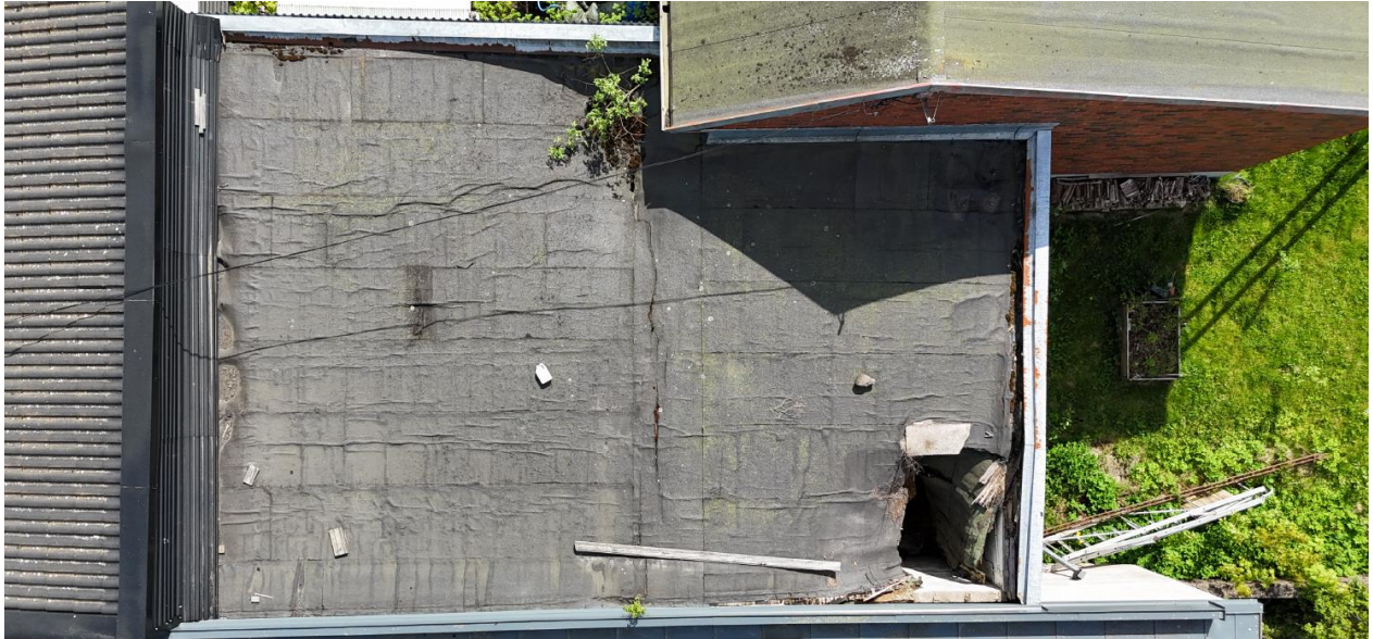
Foto F. Garagetak där delar har rasat in och övrigt tak ser ut att vara i dåligt skick.
