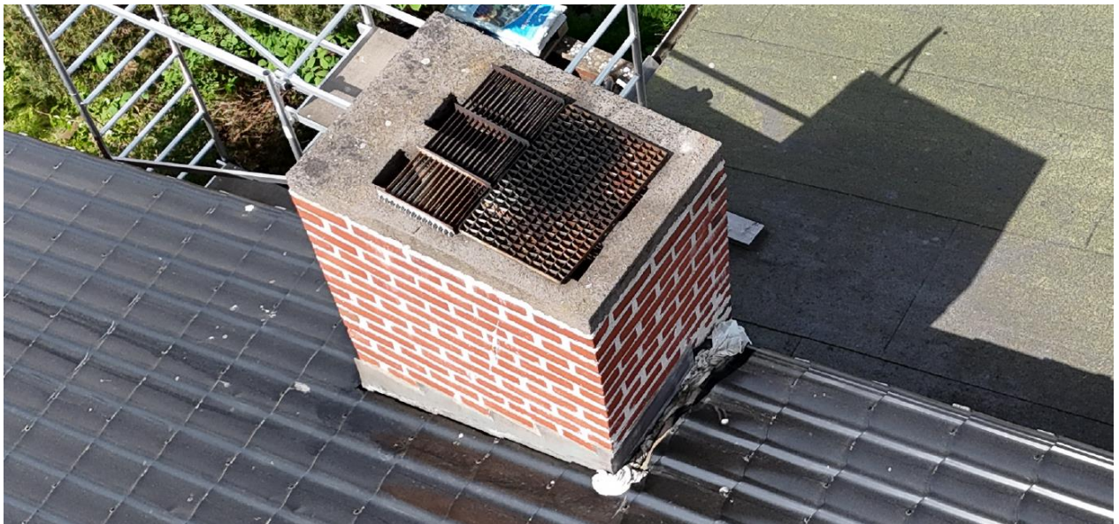
Foto B. Vid anslutning mot skorsten finns risk för fuktskador.
